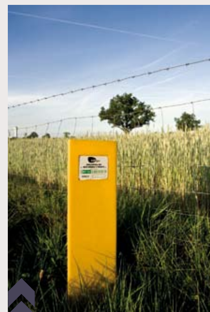
Conçue par GRTgaz et Eridanis, cette borne surveille le réseau gazier et signale, via Sigfox, les anomalies détectées.
